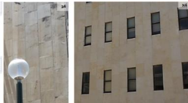
איור 14 מימין- חלונות צרים ומאונכים, ומנח האבנים בתוספת של רכטר, משמאל- מנח האבנים במבנה המקורי של מנדלסון
