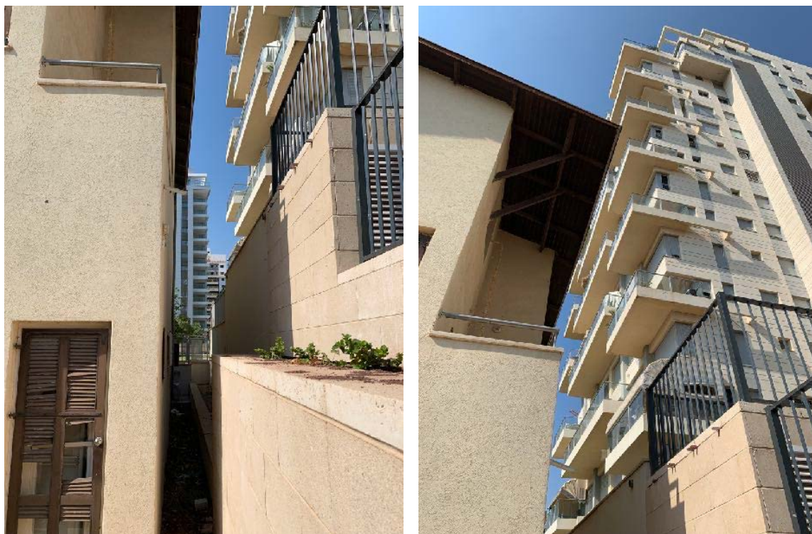
הצמדת קיר תמך של מבני מגורים גבוהים אל חזיתו המזרחית של בית קינן, ביקור באתר 2022
