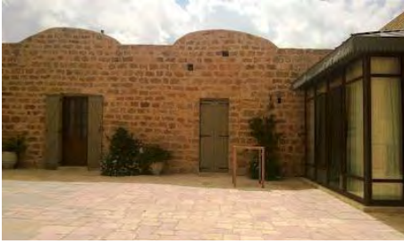
חזית פנימית בחאן בה ניתן לראות את שתי הגישות יחד. גם שחזור פתחים וחזיתות וגם בידול החדש.
